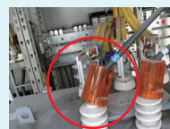
地震によりトランス端子部破損
